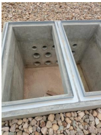
Cámaras de inspección para cables de potencia
