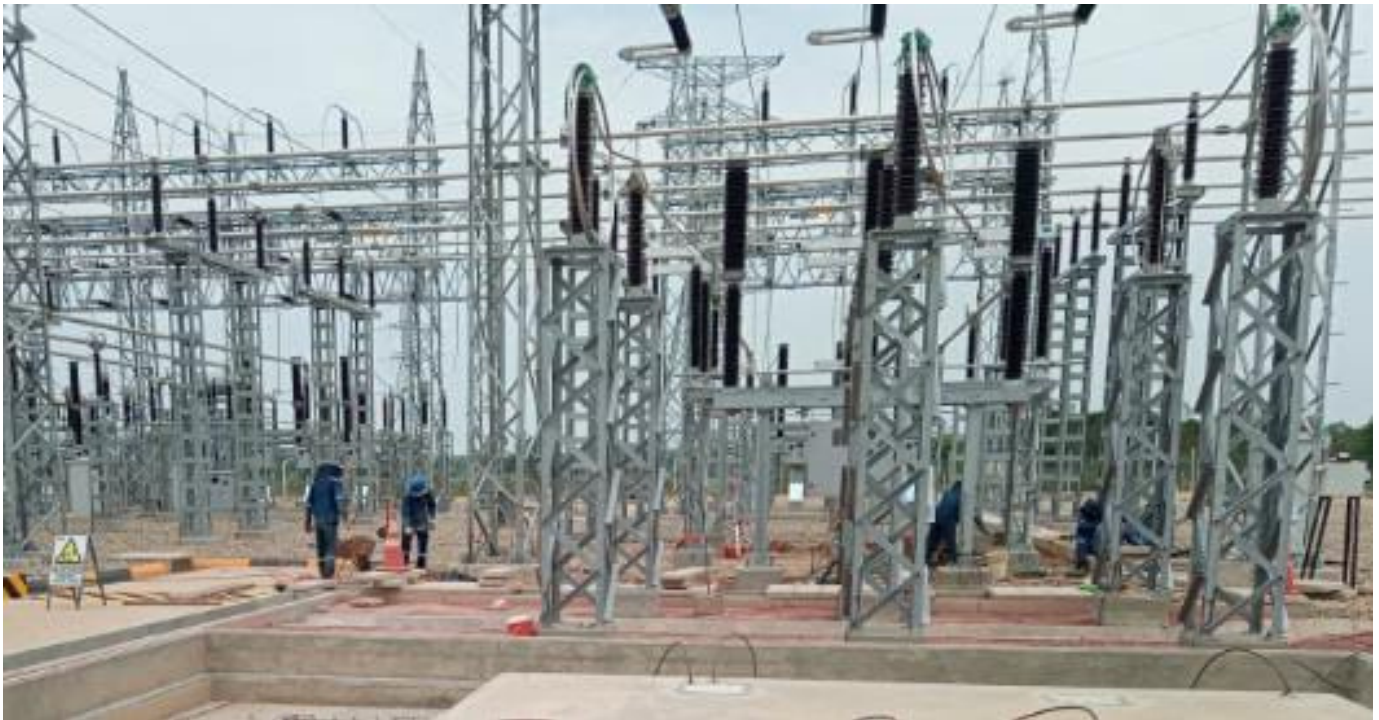
Bahía 1145 kV en construcción por parte de ENDE Transmisión, preparación de terreno y grava
